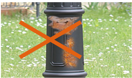
Cột, chóa Đèn bằng kim loại bị rỉ sét Metal lamppost, diffuser is rusted
